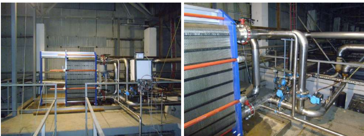
Рис. 2. Площадка с установленным теплообменником и запорно-регулирующей арматурой
