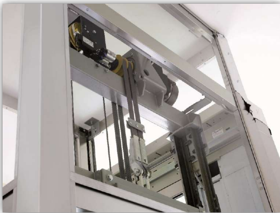
Рис. 5. Электропривод лифтового оборудования
