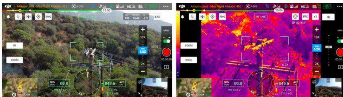
Рисунок 1. Тепловой снимок опоры ЛЭП
