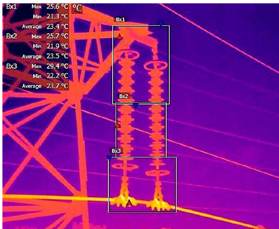
Рисунок 1. Замер температуры гирлянды изоляторов
